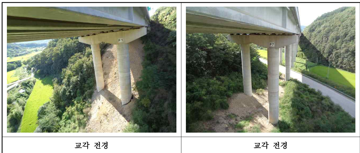
【사진 8.3.10】 교각 손상현황
